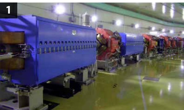
1 3GeV 陽子シンクロトロン 線形加速器から送り込まれる陽子を加速・周回するための電磁石がリング状にずらりと並ぶ陽子シンクロトロン。 陽子を30億電子ボルト(3GeV: 光速の約97%)まで加速します。
