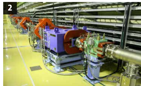
2 3GeV 陽子ビーム輸送ライン 超高真空のビームダクト内の3GeV 陽子ビームを、地下に建設されたトンネル内を通して、300mほど離れた物質・生命科学実験施設まで導きます。
